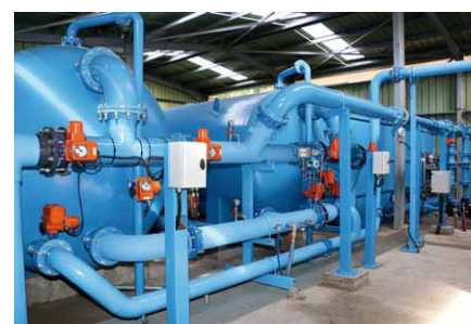
Le projet de Maatea prévoit l'installation d'une usine de traitement des eaux identique aux 3 déjà installées sur Moorea, reste à définir le volume d'eau à traiter.
